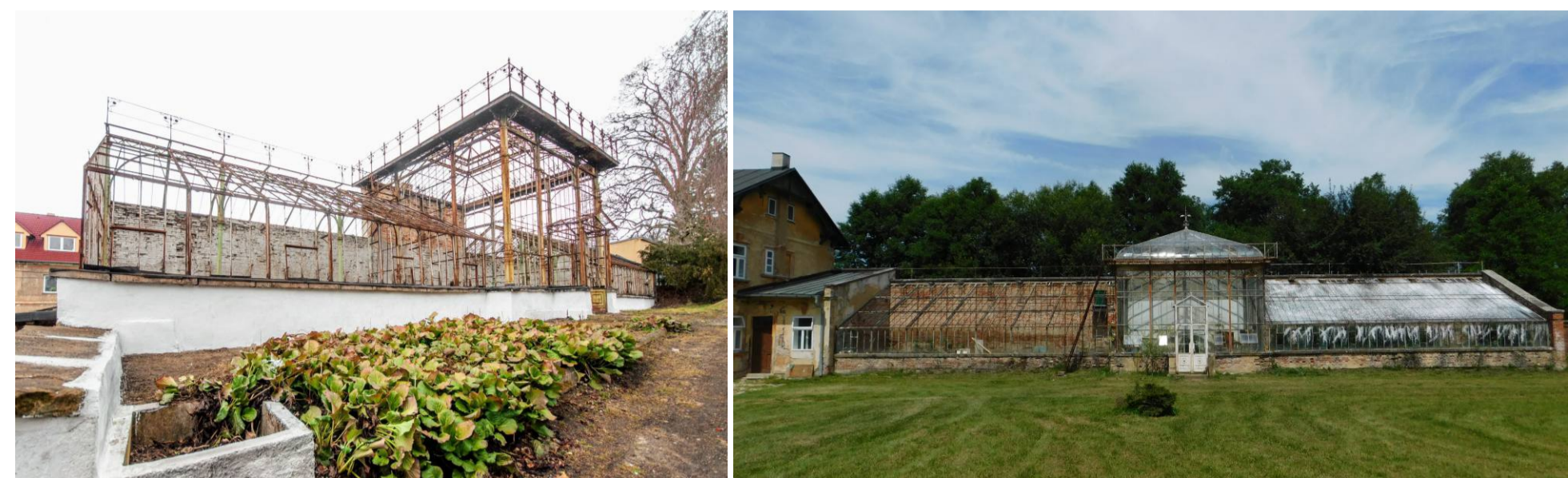
Skleníky s dominantní kovovou konstrukcí v areálech liběšického zámku a tepelského kláštera z přelomu 19. a 20. století bohužel chátrají.
